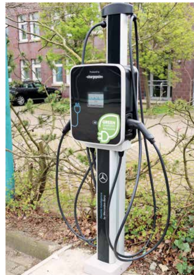
Der Standort in Bremerhaven ist mit zehn Ladesäulen ausgestattet.
